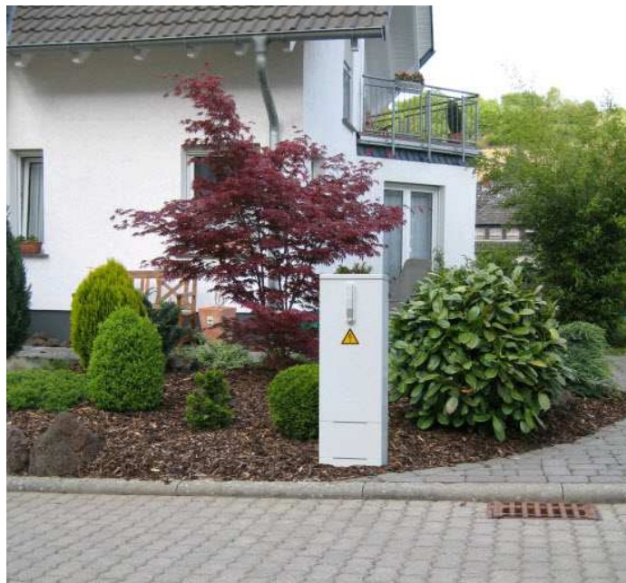
Bild 8: Beispiel für eine Haus-/Zähleranschlusssäule (Quelle: Energienetze Mittelrhein GmbH & Co. KG)
