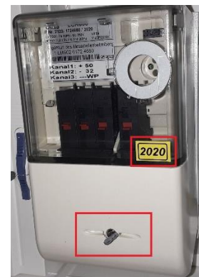
Abb. 11 Klebesiegel u. Verschlussplombe Tarifschaltgerät
