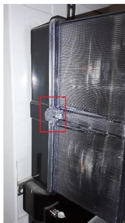
Abb. 9 Beglaubigungsplombe an einem Ferrariszähler
